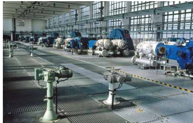
© Médiathèque Gaz de France / Noël Hautemanière
