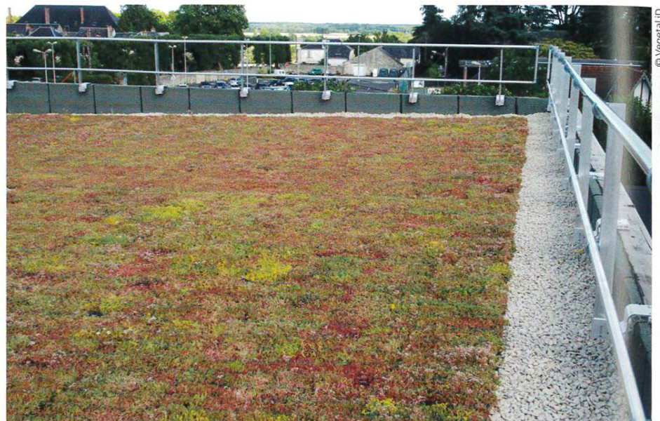
Vegetal iD a réalisé une toiture avec sa solution clé en main Hydropack Neo, pour végétaliser 320 m 2 d'une toiture d'un collège.
